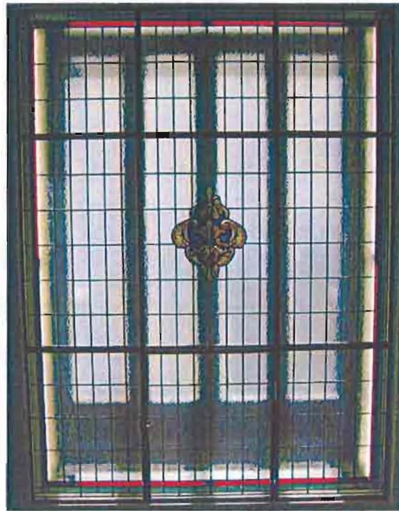
VIDRIERA DE ESCALERA PLANTA BAJA Nº 9b
