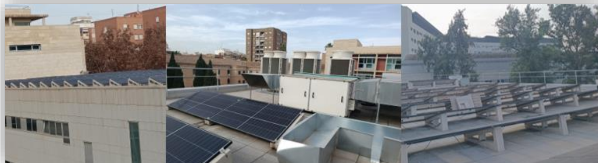
Foto: plantas fotovoltaicas en el Hospital General Universitario Reina Sofía de Murcia.
