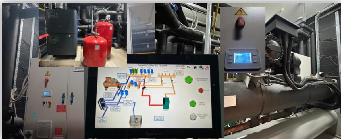
Foto: instalación de climatización del palacio de San Esteban de Murcia.
