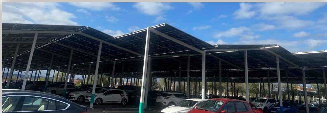
Foto: instalación solar fotovoltaica de autoconsumo en el aparcamiento del Hospital Universitario San Pedro de Logroño.
