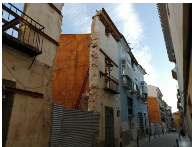
Gráfico 13. Calle del centro de Lorca con solares vacíos y fachadas apuntaladas
