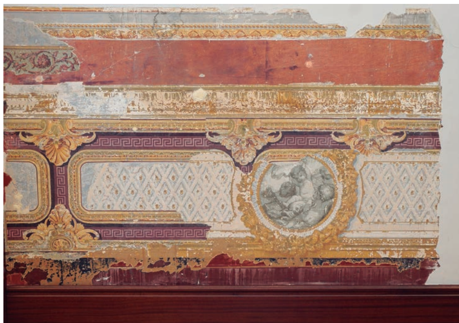
Figura 8. Zócalo de papel pintado de la segunda mitad del siglo XIX en un salón de la primera planta del Palacio del Congreso de los Diputados, actualmente Despacho de la Vicepresidencia primera. Fuente: ECRA SERVICIOS INTEGRALES DE ARTE, S. L.
